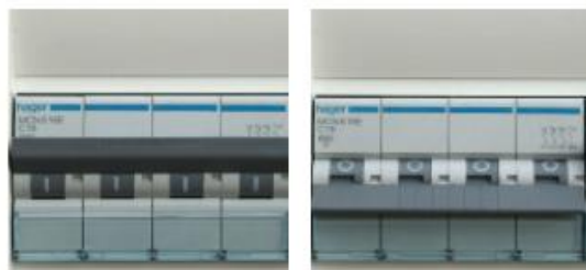
Når "I" er synligt, er installationen tilkoblet, og når "0" er synligt, er den enkelte installationsgruppe afbrudt.
